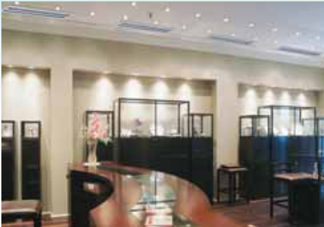
Climatiseur avec conduit caché dans le plafond
